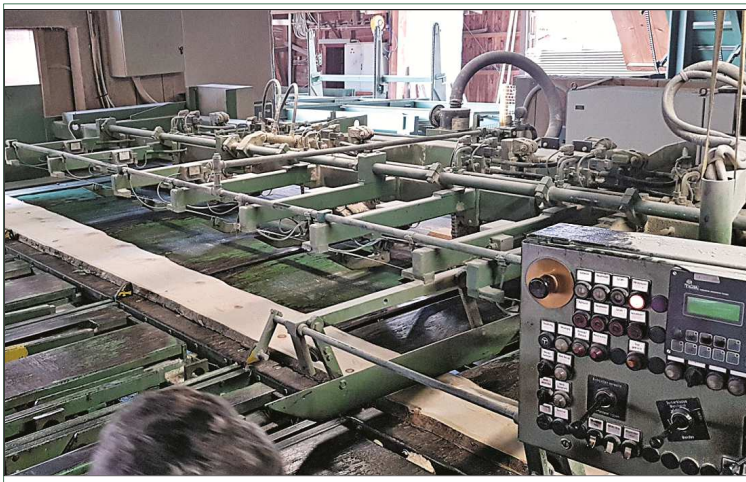
Alte Besäumenanlage bei der Sägerei Lippuner vor dem Umbau im August 2018: Messbalken mit Luftdüsen zum Abtasten der Bretter. Foto: EWD
