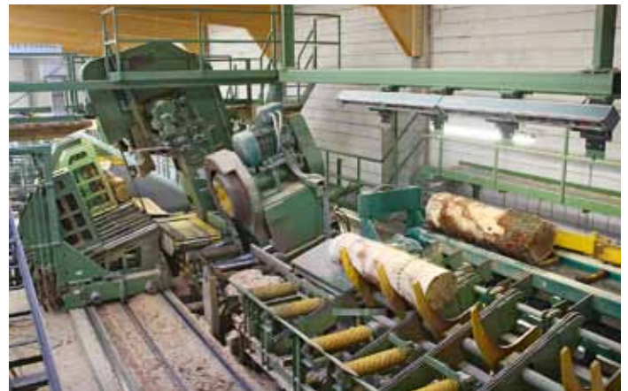
Bandsägewerk von Koddenbrock: Bei EWD führt man diese Installation als Beispiel für ein „Einmannsägewerk“ an
